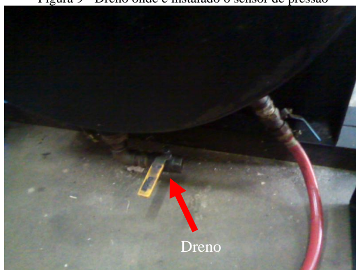
Figura 9 - Dreno onde é instalado o sensor de pressão
