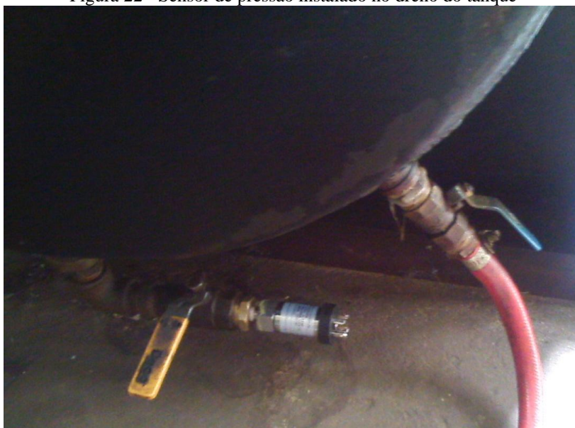
Figura 22 - Sensor de pressão instalado no dreno do tanque
