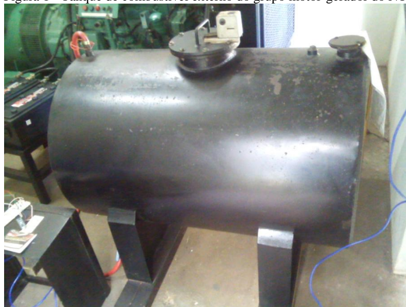
Figura 1 - Tanque de combustível externo do grupo motor-gerador do NTI
