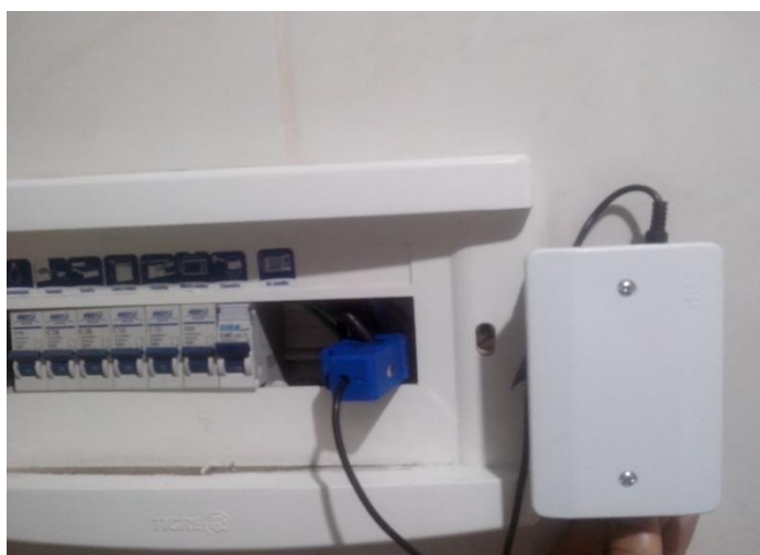
Figura 11 - Sensor ligado a caixa de distribuição
