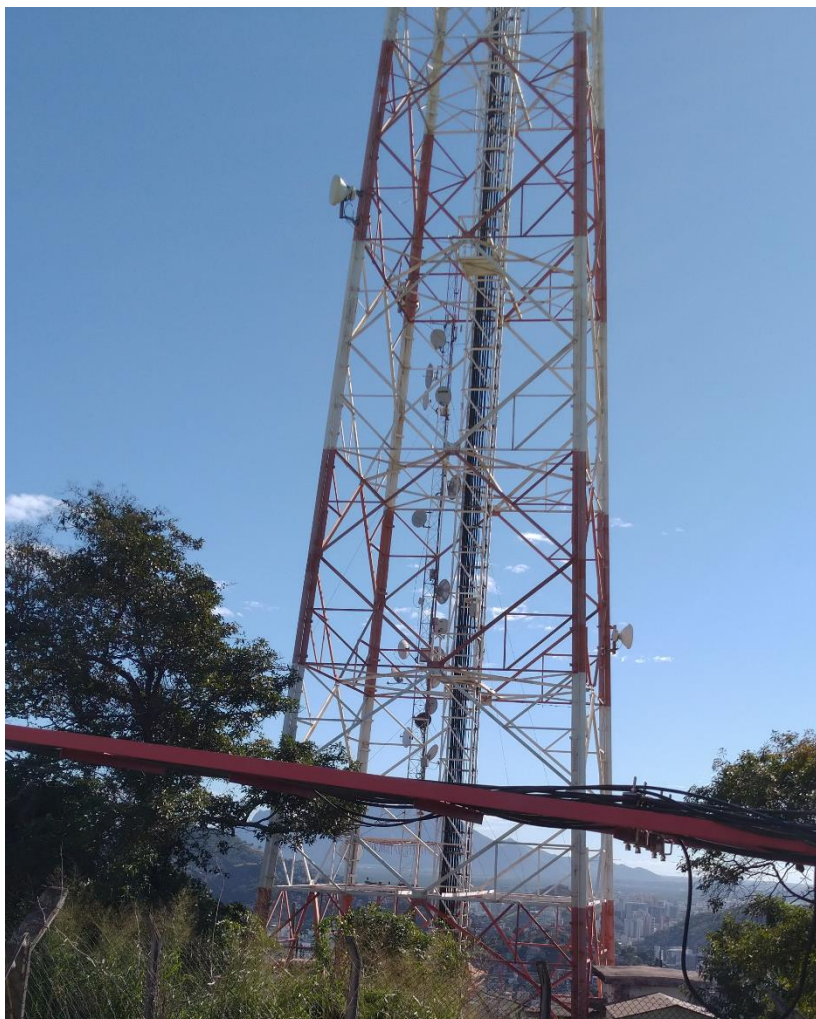
Figura 25 – Torre autoportante que causa interferência da linha de visada.
