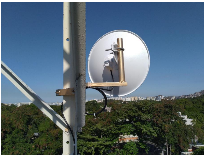
Figura 17 – Detalhe da instalação do rádio no CT6 -UFES
