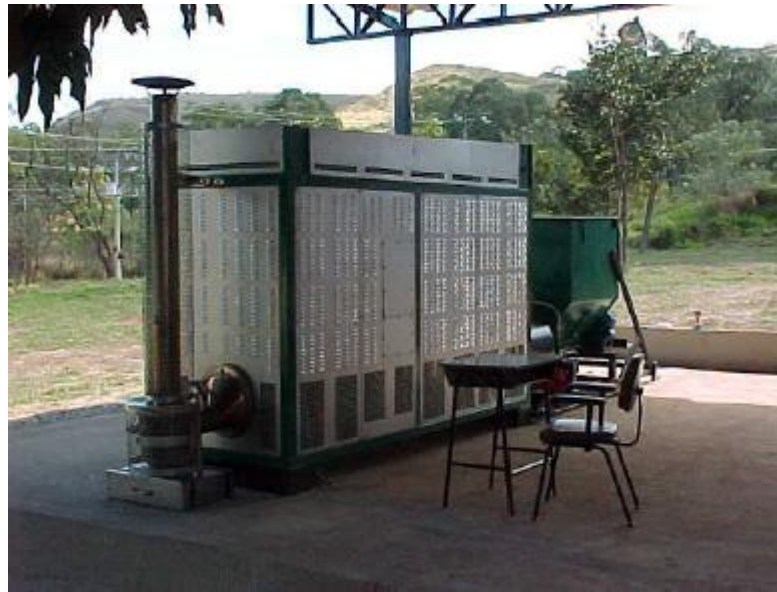
Figura 2 – Microturbina a Líquido Orgânico instalada na EFAP, em Sete Lagoas/MG
