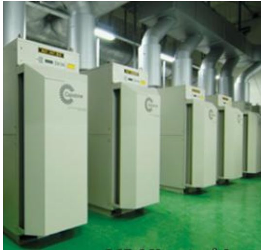
Figura 9 – Microturbinas Capstone em aplicação industrial
