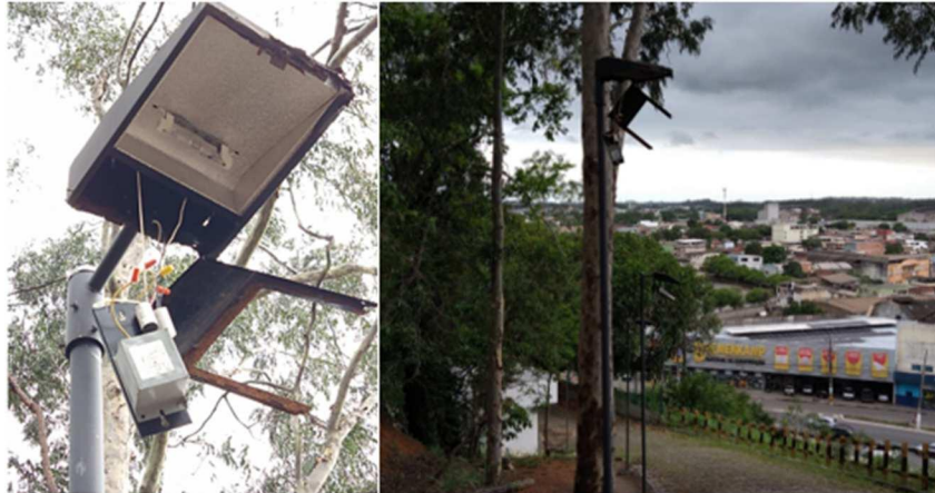
Figura 30 – Iluminação externa danificada.
