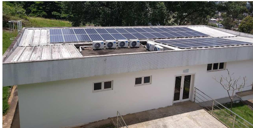
Figura 33 – Unidades condensadoras instalados no prédio da administração
