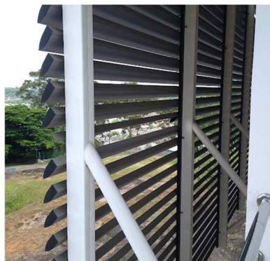
Figura 9 – Estrutura de sombreamento do tipo brise instalada em fachada do CPID.
