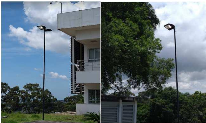
Figura 42 – Postes de iluminação externa com lâmpadas de vapor metálico
