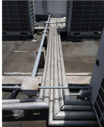
Figura 37 – Tubulação de refrigeração do sistema Multi Split
