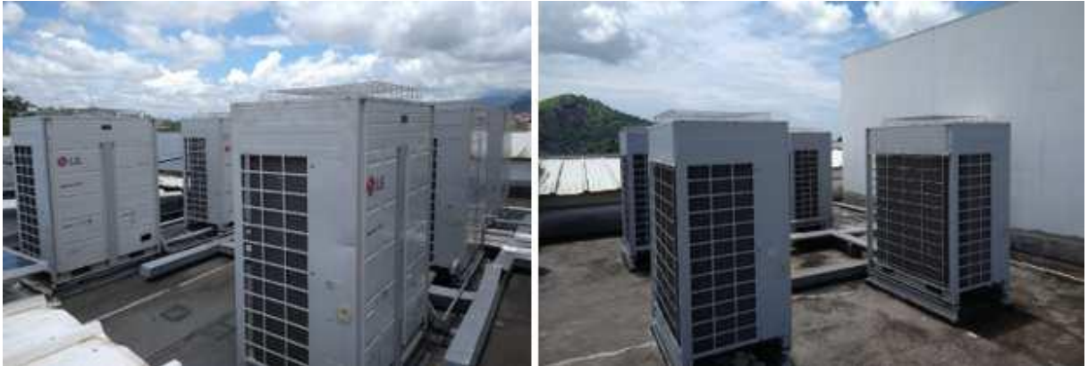
Figura 32 – Unidades condensadoras instaladas na cobertura
