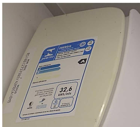
Figura 36 – Etiqueta de nível A em ar-condicionado tipo split hi-wall, instalado na administração.
