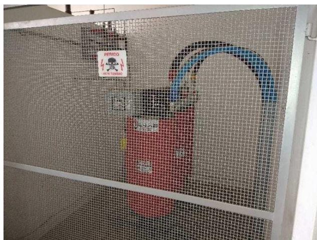
Figura 41. Transformador a seco
