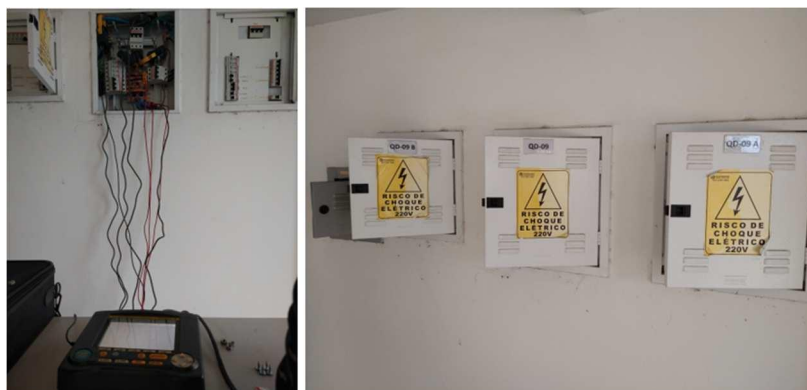
Figura 26 – Medição com analisador de energia dos quadros de distribuição referentes à iluminação externa.
