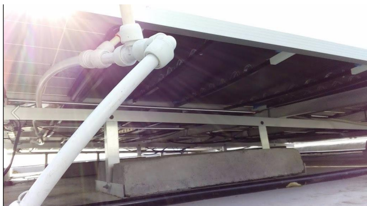
Figura 12 - Trocador de calor instalado sobre as barras de alumínio
