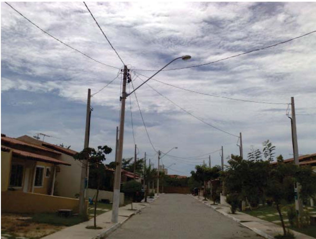
Figura 17 – Exemplo de rede construída sem cadastro
