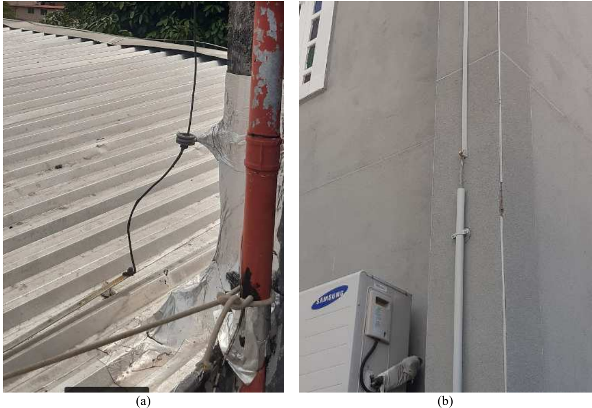
Figura 13 – Subsistema de descida. (a) fio de cobre para haste de alumínio, (b) haste de alumínio fio de cobre.
