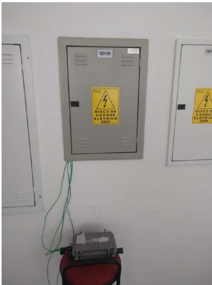
Figura 16 – Instalação do TDR1 no QD-08 com cabo de tamanho reduzido
