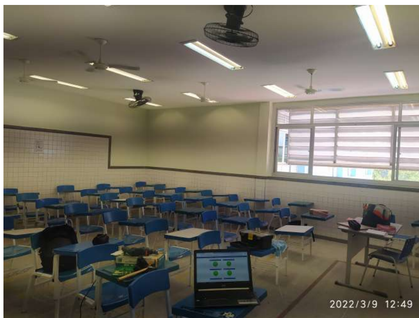
Figura 35 – Sala de aula do Colégio Estadual do Espírito Santo com todas as lâmpadas acesas.
