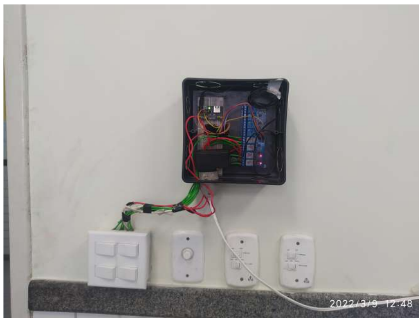
Figura 34 – Sistema montando em sala de aula do Colégio Estadual do Espírito Santo.
