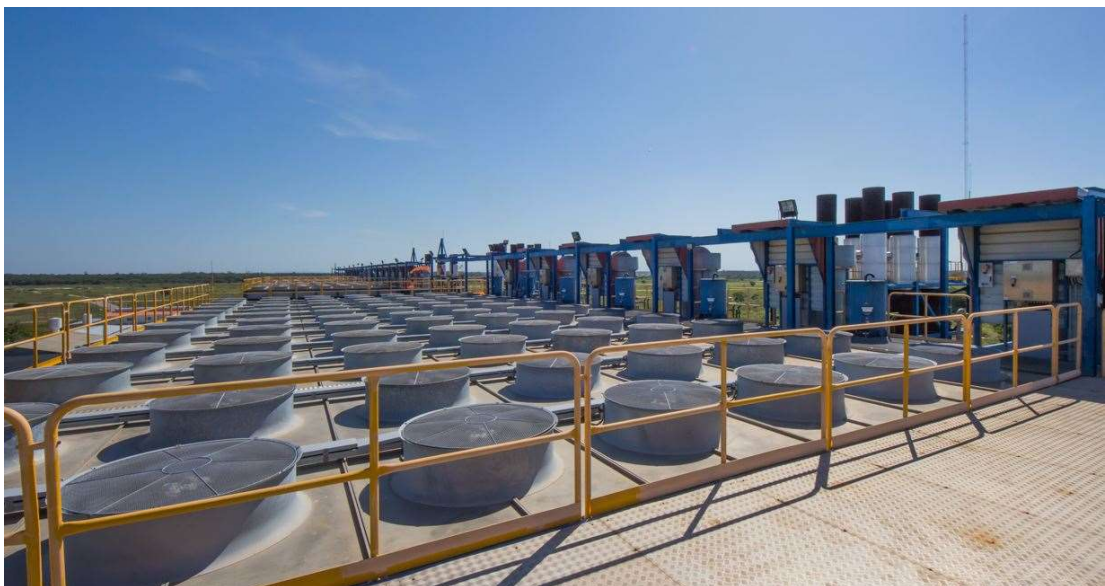
Figura 4 – Conjunto de ventiladores que compõem o sistema de resfriamento
