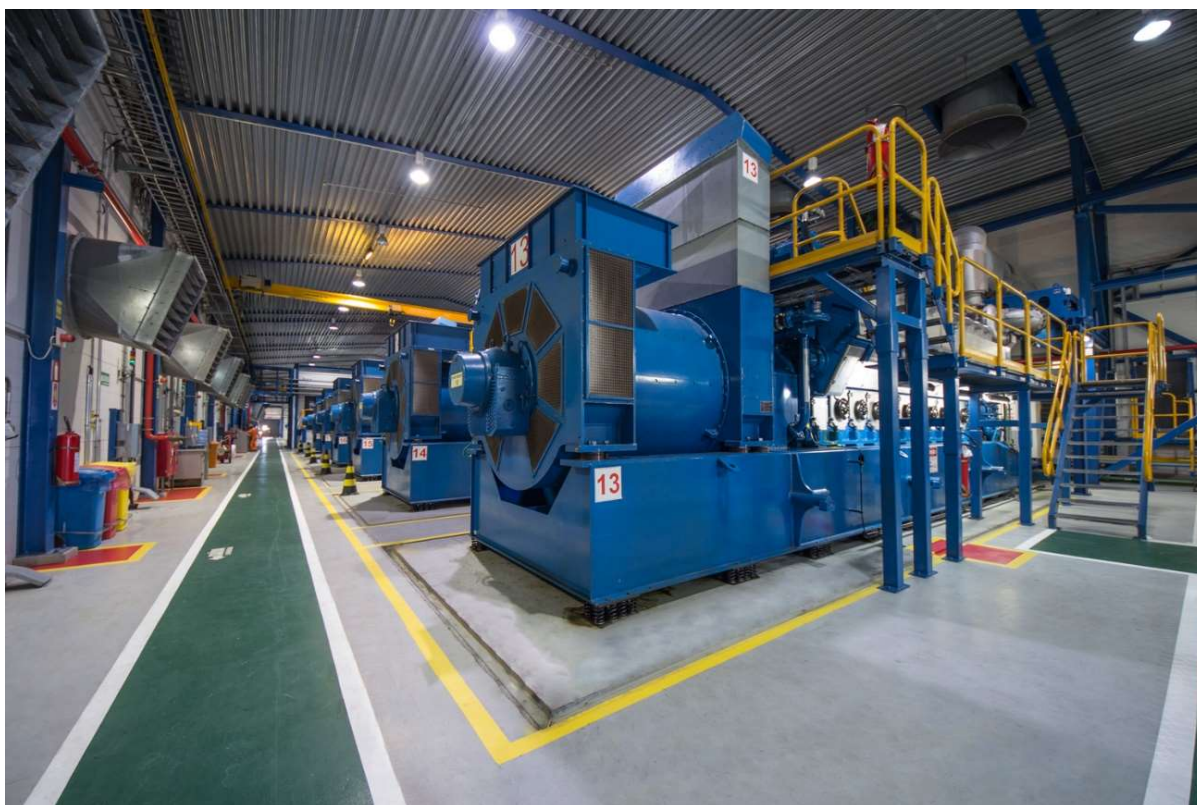
Figura 2 – Moto-gerador empregado na UTE LORM
