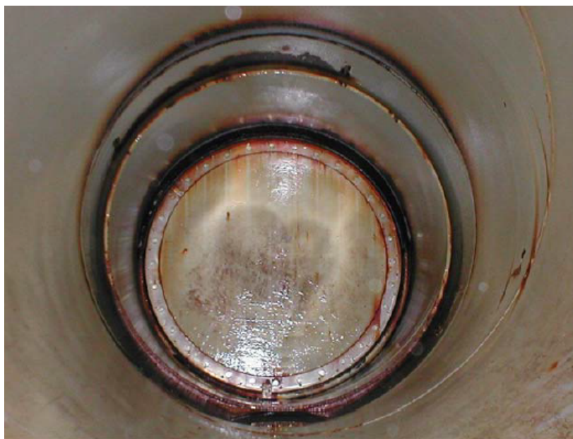
Figura 1 - Erosão causada pela cavitação em uma tubulação
