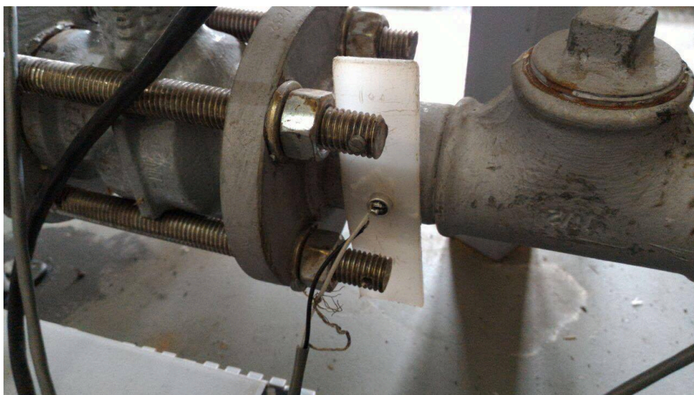
Figura 6 - Microfone de eletreto acoplado à tubulação.
