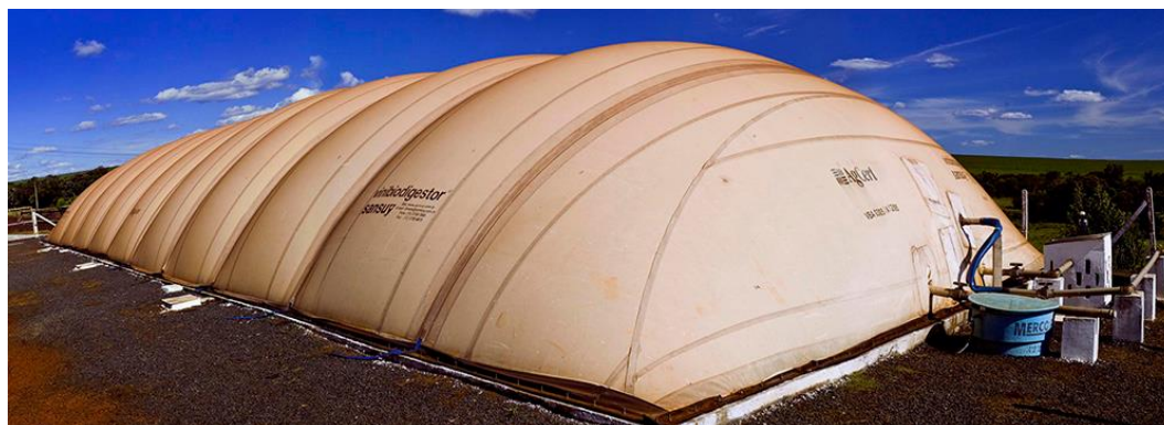
Figura 5 – Biodigestor do tipo lagoa coberta
