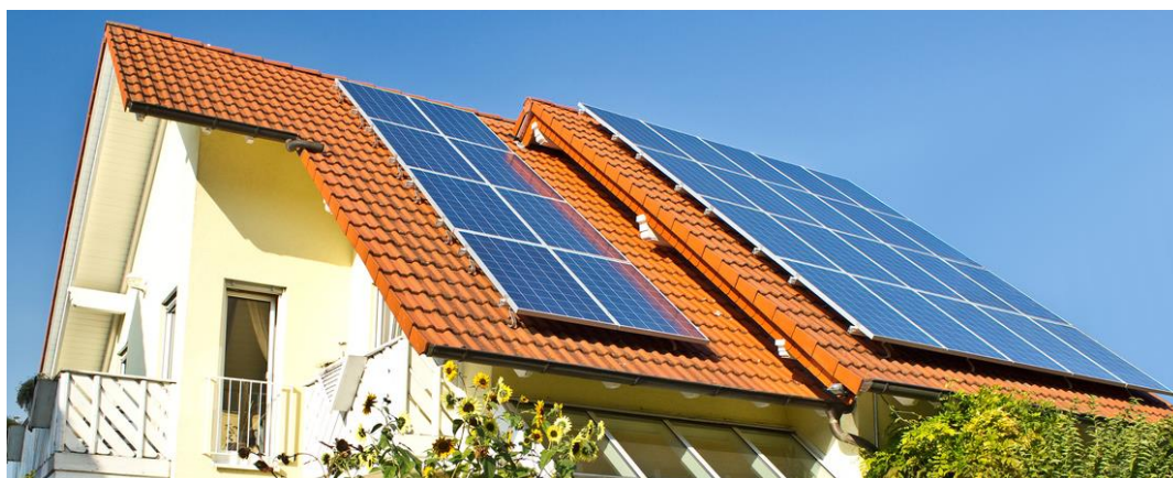
Figura 18 – Sistema fotovoltaico de microgeração instalado no telhado de uma residência
