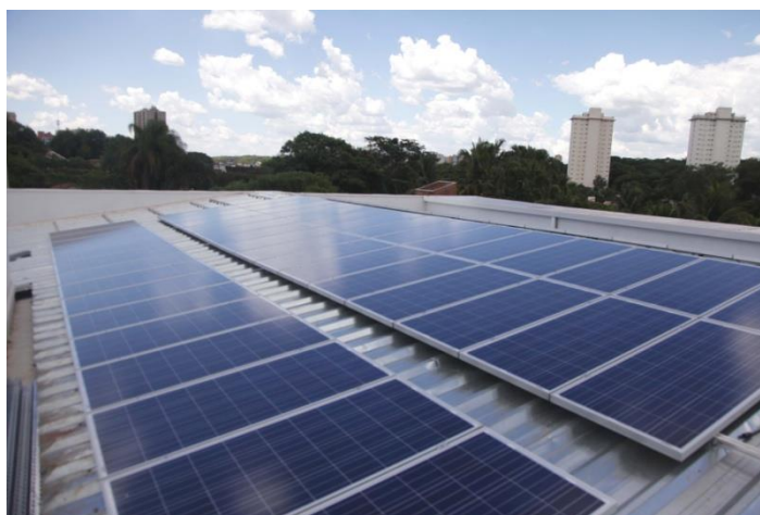
Figura 13 – Conjunto de módulos fotovoltaicos
