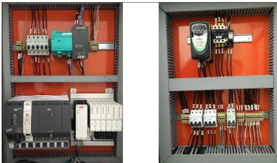
Figura 10 – Painel de comando (esquerda) e painel de potência (direita)
