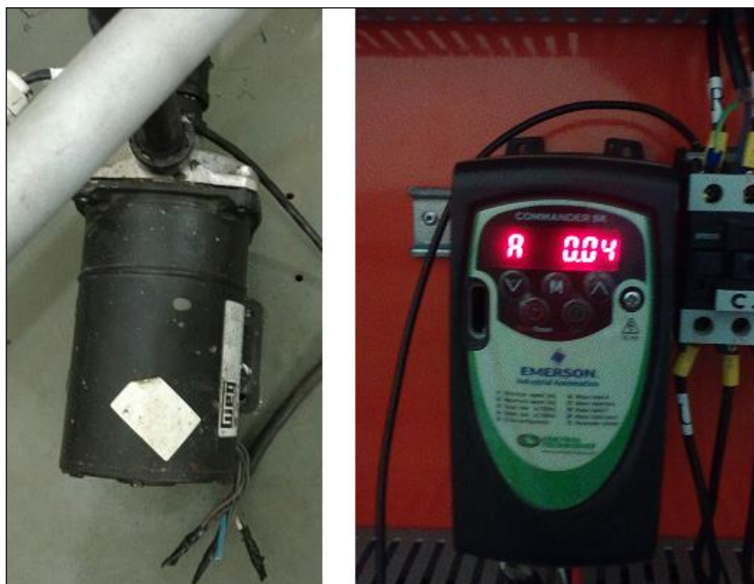
Figura 5 – Bomba (esquerda) e inversor de frequência (direita)
