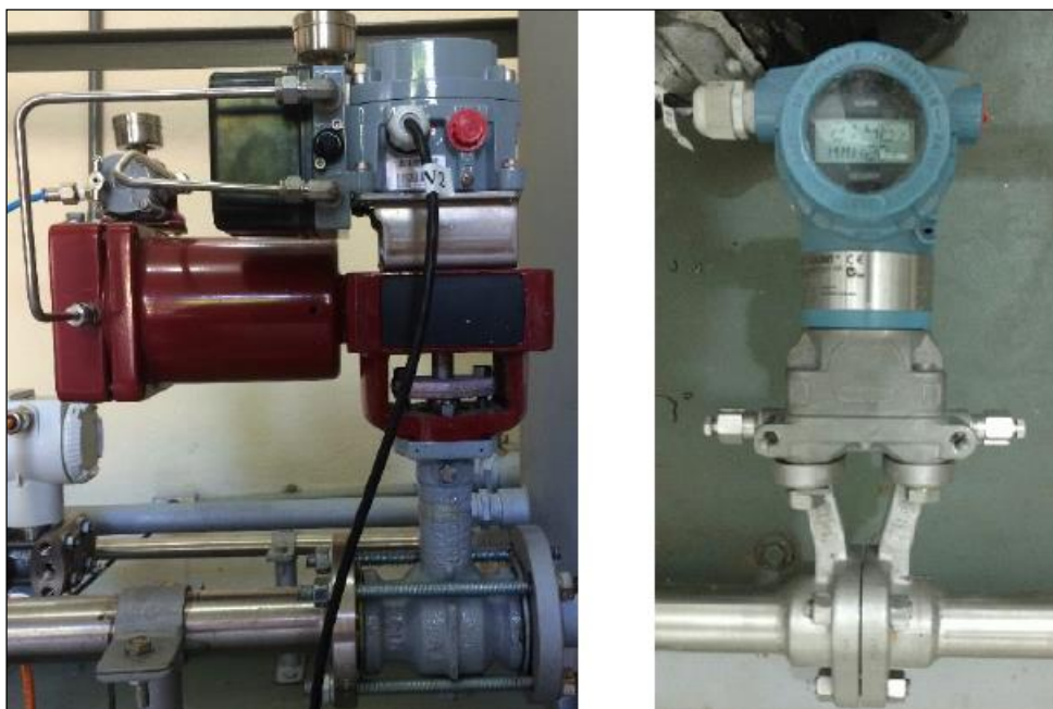
Figura 6 – Válvula de controle de vazão (esquerda) e transmissor de pressão diferencial 3051 (direita)
